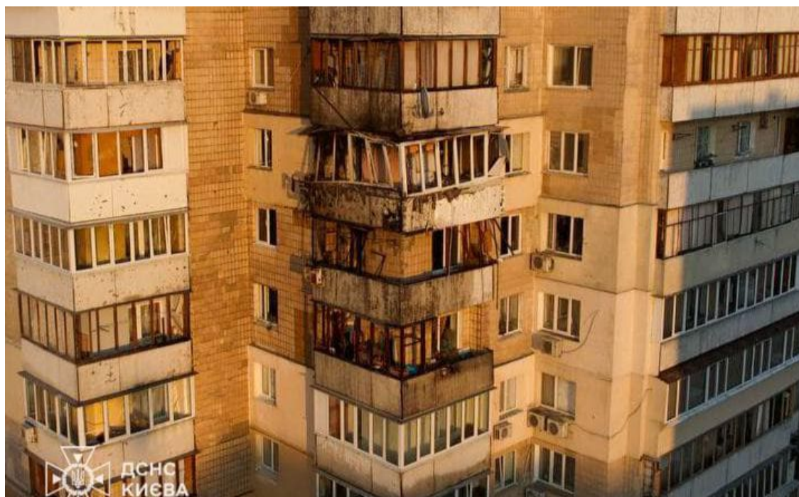
Balkony části výškové budovy poškozené ruskou raketou. Foto: DSNS z Kyjeva
