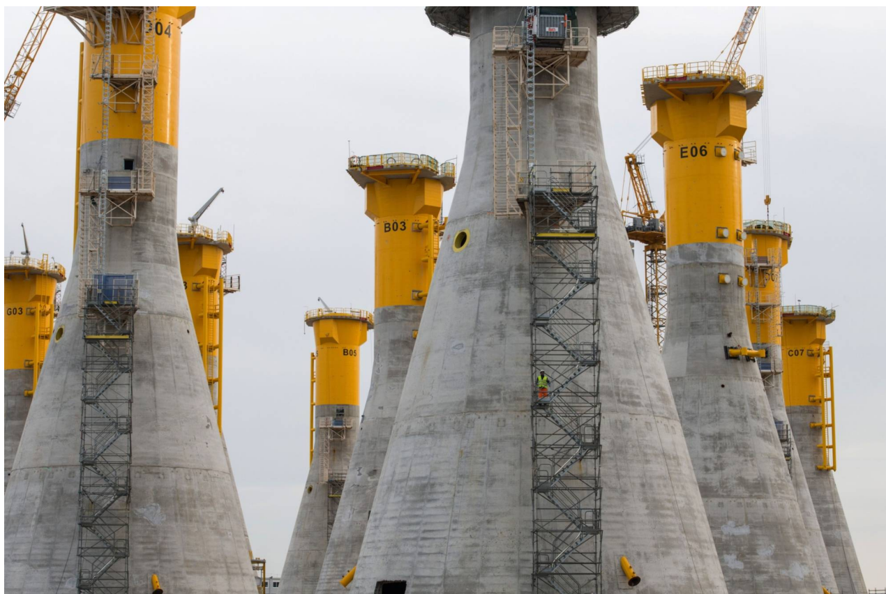
Základy větrných turbín ve výstavbě v Le Havre ve Francii v dubnu 2022 | BLOOMBERG
