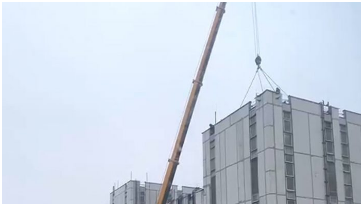
Umísťování dalšího komplexu Pancir S1 na výškovou budovu v Moskvě
