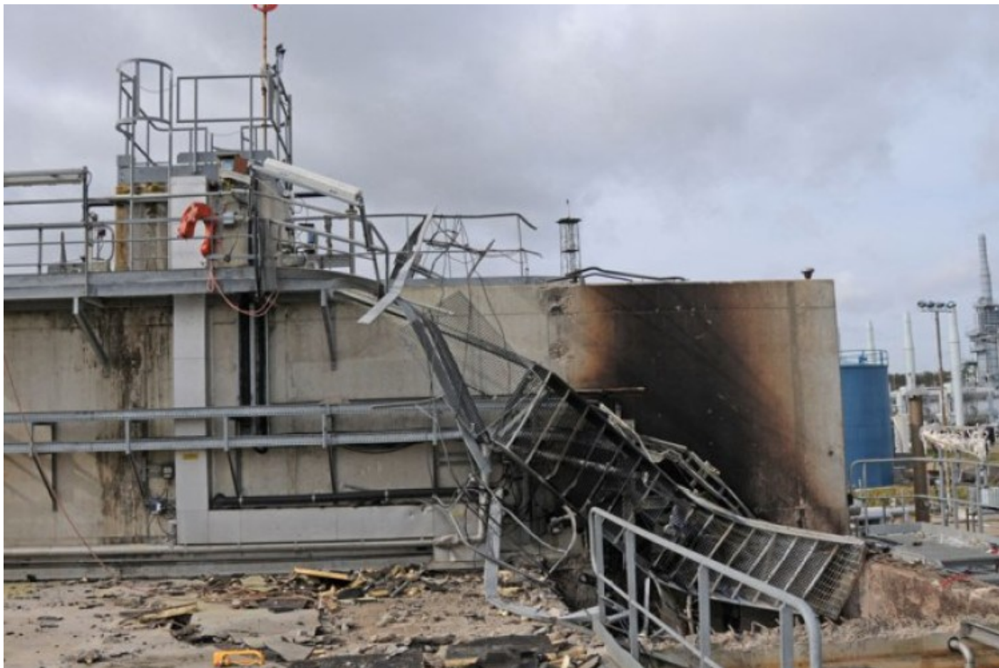
Poškození plynového terminálu Bacton výbuchem
